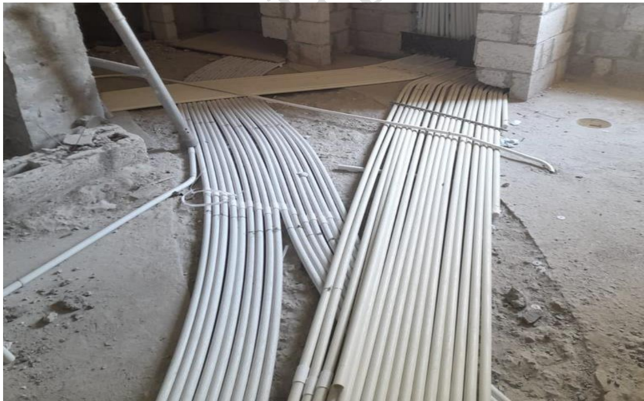
Electrical Conduit Piping
